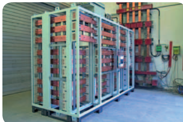
Prüfung zum Nachweis der Kurzschlussfestigkeit an einer Niederspannungs-Schaltgerätekombination Verification of short-circuit withstand strength on a LV switchgear assembly
