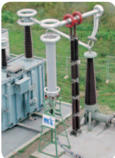
Präqualifikationsprüfung an einem 400-kV-Kabelsystem/Prequalification test on a 400-kV cable system
