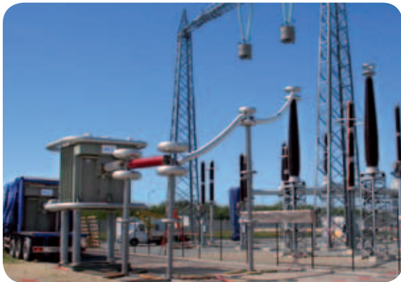
Inbetriebnahmeprüfung mit TE-Messung an einem 400-kV-Kabelsystem in Italien/Commissioning test with PD measurement on a 400-kV cable system in Italy
