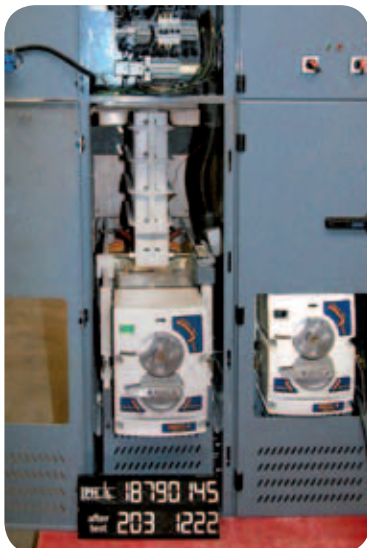
Prüfung mit Stoß-Kurzschluss-Gleichstrom an einem Schnellschalter in einer GS-Schaltanlage Test at current peak value under transient conditions on a high-speed circuit-breaker in a DC switchgear
