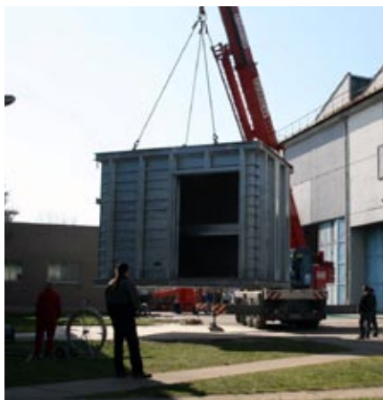
Aufbau im IPH-Hochleistungsprüffeld/ Installation at IPH high-power test laboratory
