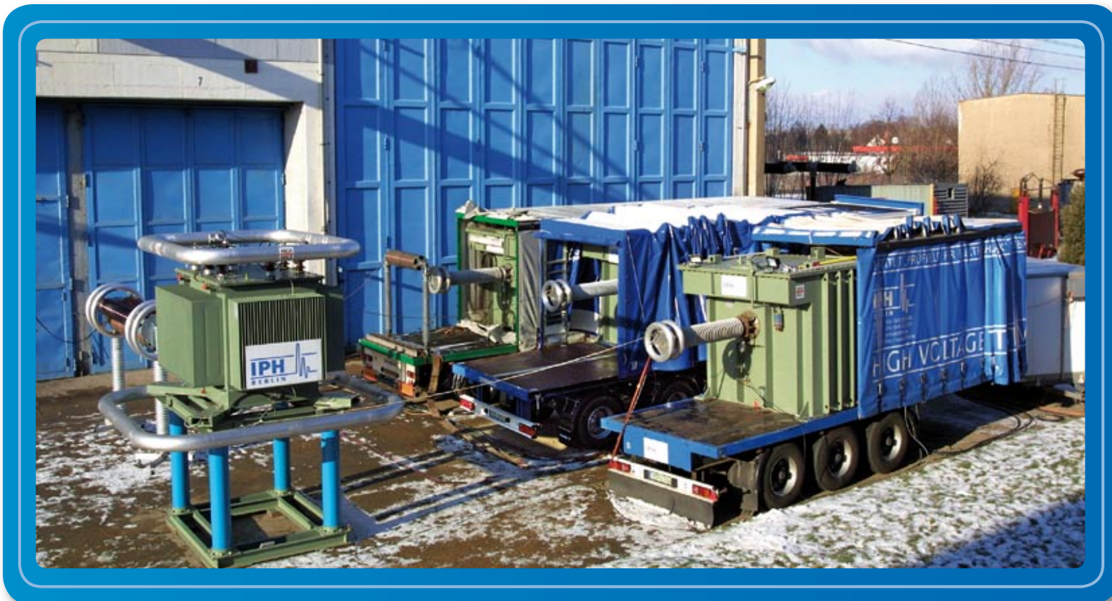
Inbetriebnahme der weltweit größten mobilen WS-Prüfanlage / Commissioning of the largest mobile AC voltage test system worldwide
