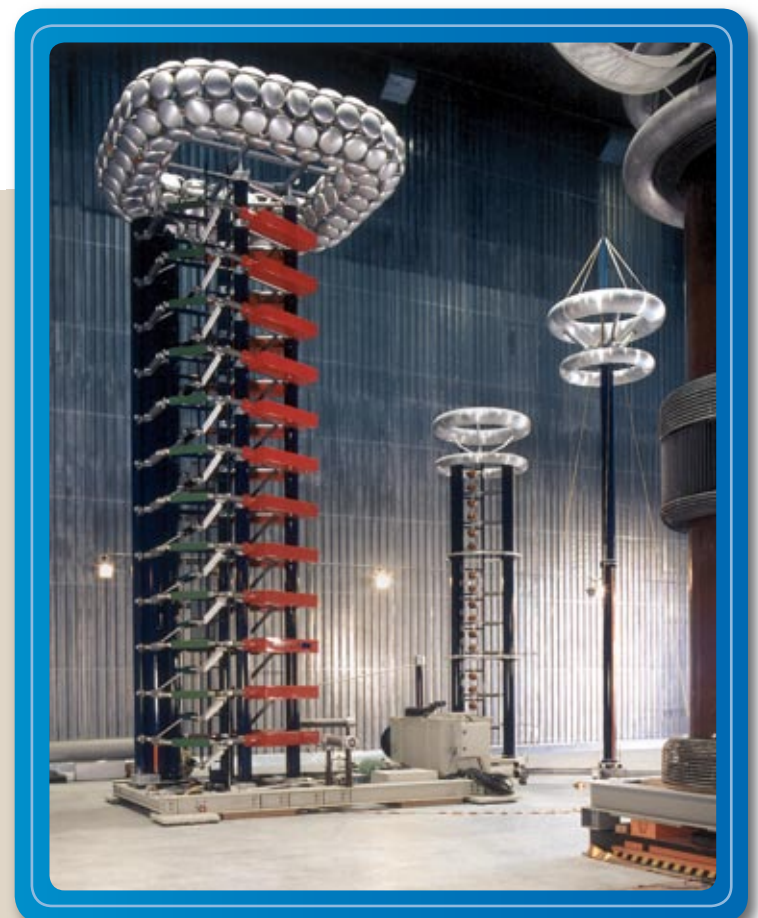
Neue Hochspannungshalle/ New high-voltage hall
